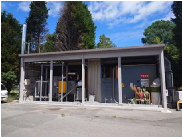
木質バイオマスボイラー Wood biomass boiler
