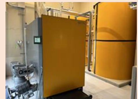
木質バイオマスボイラー Wood biomass boiler
